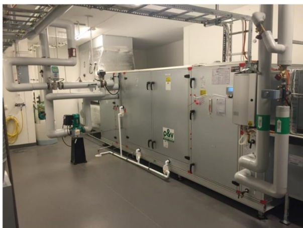
Bild 1 Ventilationsaggregat med HSB FTX på Adolfsbergs Vårdcentral
