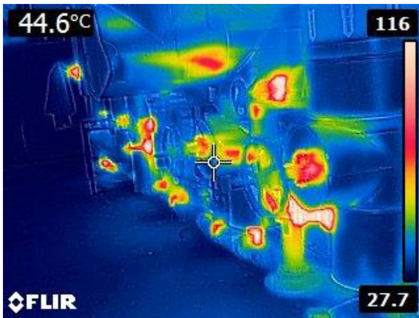
Figur 3. Bild från ångcentralen. Vissa delar är 116 av utrustningen är 116 °C och rumstemperaturen i utrymmet är 27,7 °C.
