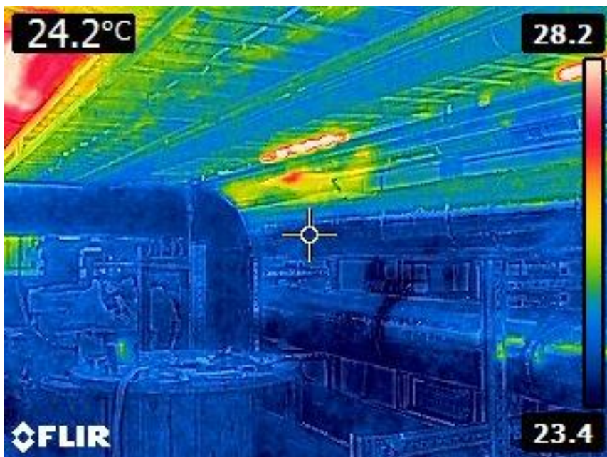
Figur 6. Termokameran avslöjar varma komponenter. Det vita i bild är lysrör och det i rött är värmeförluster som borde åtgärdas.
