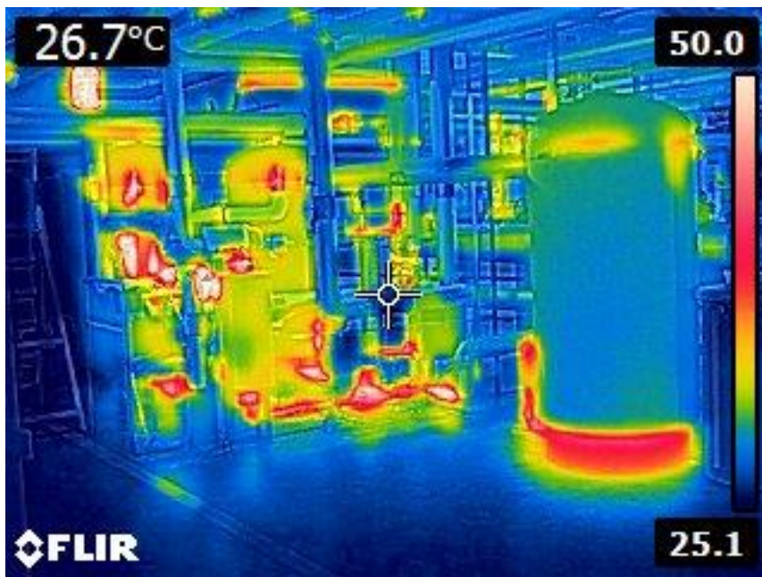
Figur 5. Legionella skyddsutrustning visar stora värmeförluster trots att anläggningen är relativt nyinstallerad.
